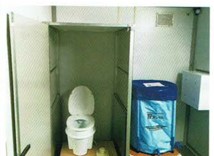
▲外部に雨水タンクを取付け簡易水洗トイレとして使用
